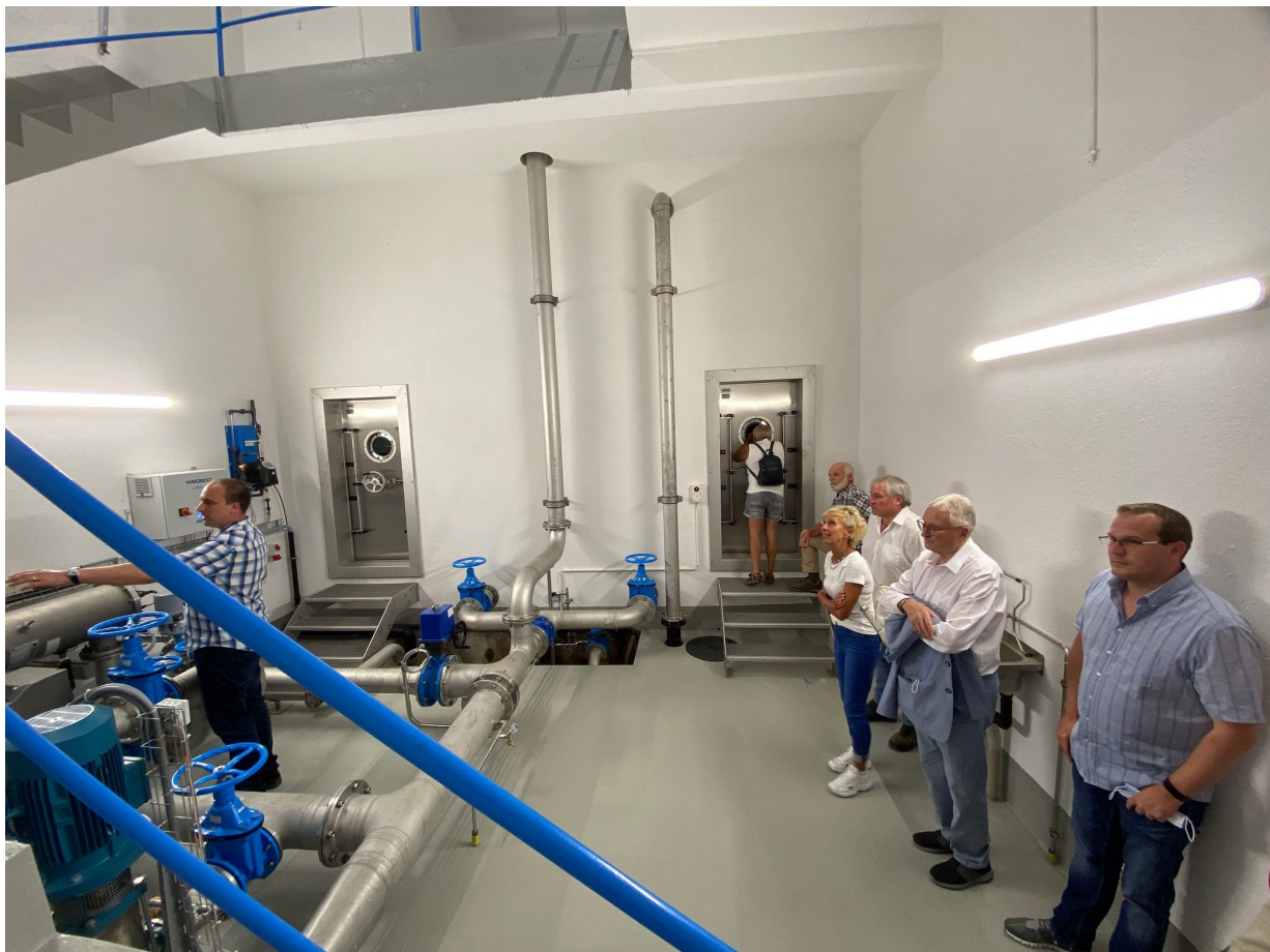
Unser Technischer Leiter Andreas Zimmermann erklärt den Anwesenden das neue Reservoir
